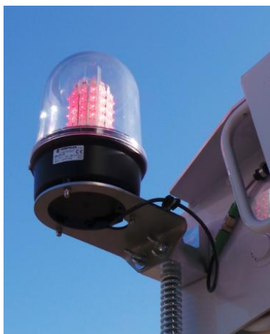
Afb. 10-20 Vliegobstakel baken in bedrijf
